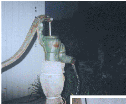
◀管井戸(手押しポンプ)
