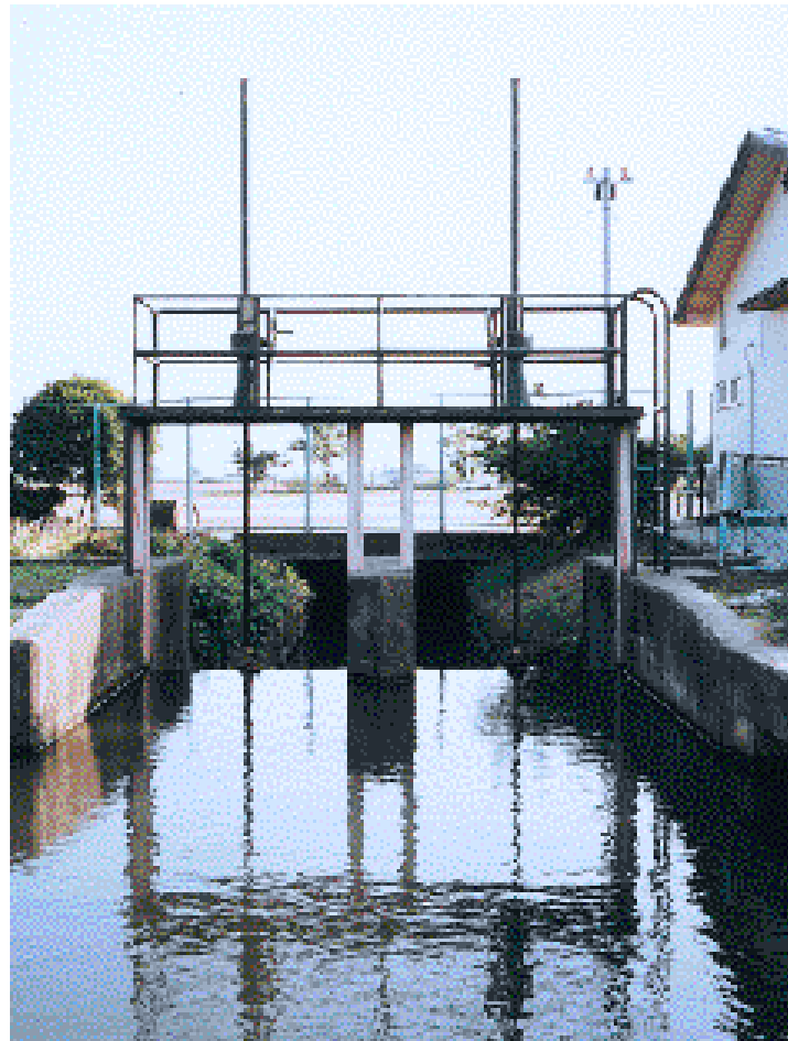
▲川の流出水量を調節する面戸(めんこ) 福堂
